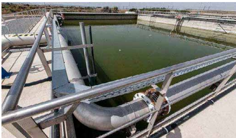
Estación depuradora en la provincia de Toledo. / YOLANDA LANCHÁ
